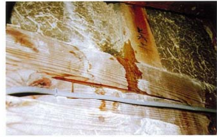
▲検査液がしみ込んだ箇所 (木造家屋の屋根裏)
